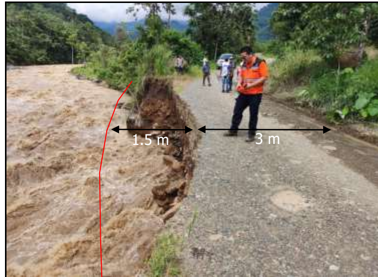
Foto 2: Se muestra socavón que amenaza con seguir erosionando la vía.
